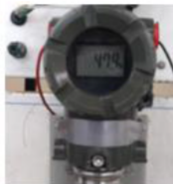
Figura 3. Transmisor de presión marca Yokogawa.
