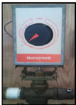
Figura 7. Válvula de control Honeywell.
