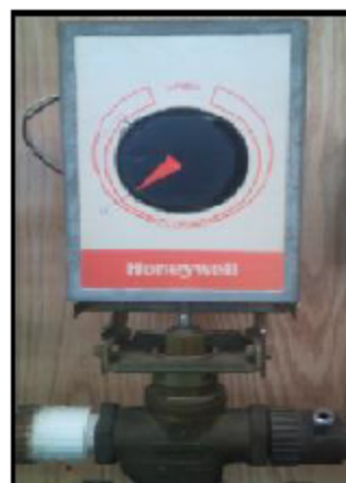
Figura 5. Válvula de control Honeywell.
