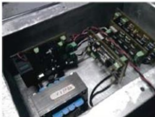
Figura 10. Tarjetas de circuito impreso pertenecientes al transmisor colocado en campo para sensar y transmitir las variables de temperatura y vibración presentes en un equipo de bombeo.
